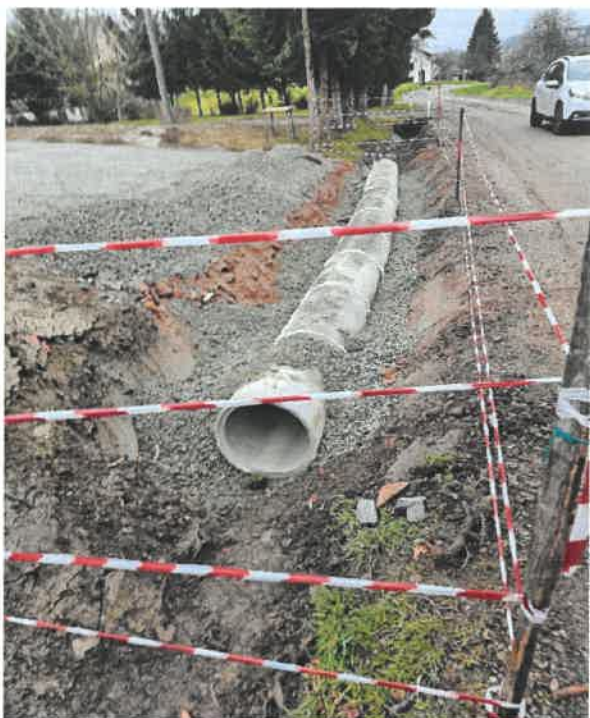
Gradnja priključka brez soglasja
